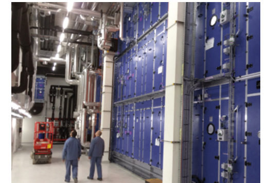
Drei selbsttragende RL-T-Geräte mit insgesamt 160.000 m³/h Volumenstrom
